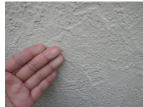
←チョーキング 外壁をこすって 手に白い粉がつくのは 劣化が始まっている 証拠です！
